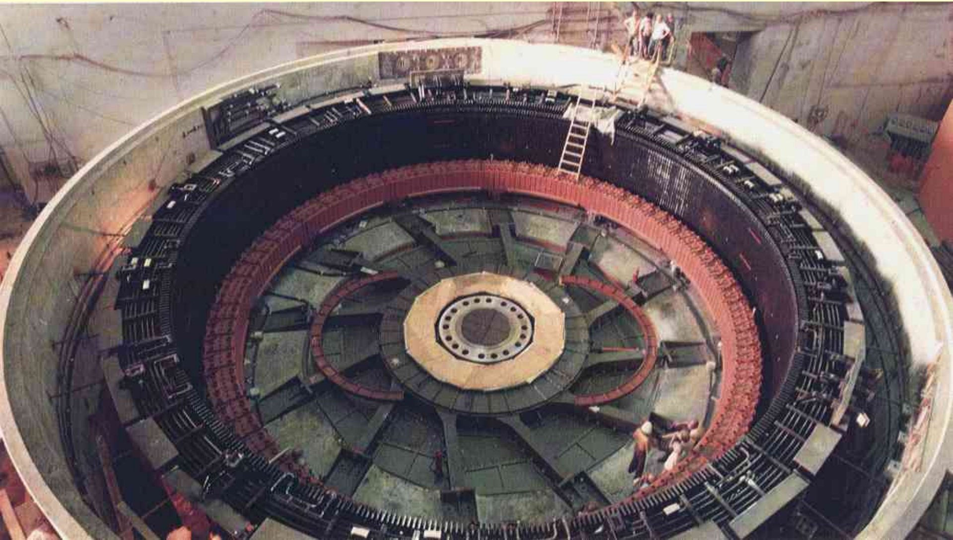
Centrale de São Simão, 6 alternateurs, diamètre 17,5 m, 282 MVA
